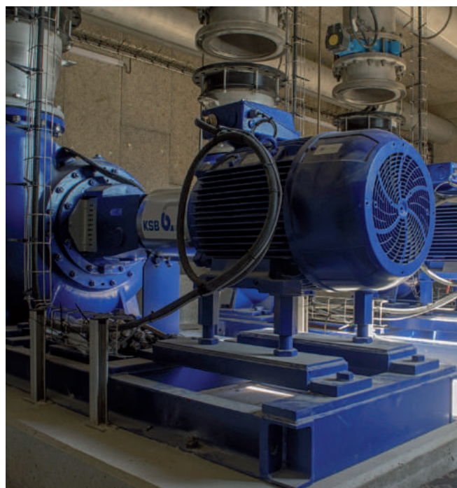
Pompes de recirculation
